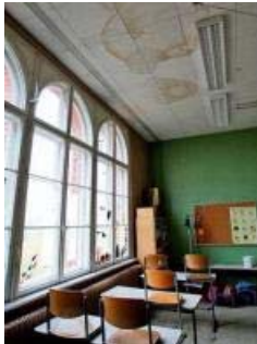
Die Gustav-Falke-Schule in Wedding. Riesige Wasserflecken sind an der Decke zu sehen
